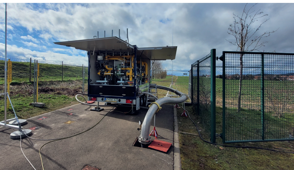
Foto: Ohra Energie GmbH
