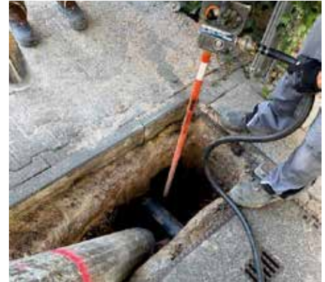
Die Druckluftlanze bringt Unterstützung, wenn es allzu eng wird – und bei Bedarf auch zwischen Leitungen
