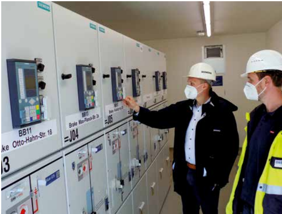
Umweltfreundliche Schaltanlagentechnik bei EWE NETZ GmbH setzt auf das klimafreundliche Isoliergas Clean Air
