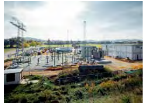
Das neue Umspannwerk Bautzen-Süd wird effizient erneuerbare Energien ins überregionale Hochspannungsnetz einspeisen.
