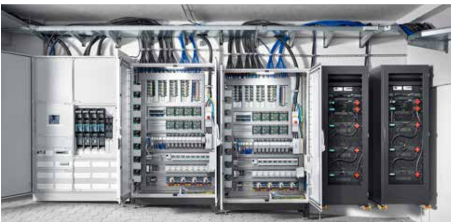
Das Herzstück der Technik in der Tiefgarage (von links nach rechts): Elektroverteilung, Ladeinfrastruktur, Batteriespeicher
