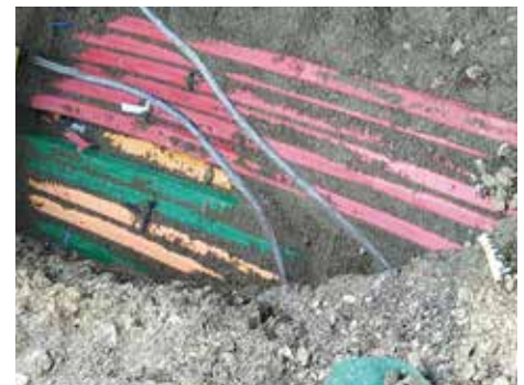
Querende Glasfaserkabel direkt über den Warnbändern von Strom-, Gas- und Wasserleitungen
