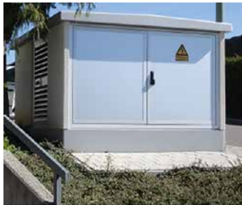
Im Umfeld der Trafostationen muss immer mit Kabelanlagen, Rohren, Erdungsanlagen und Verbindungsstellen gerechnet werden.
