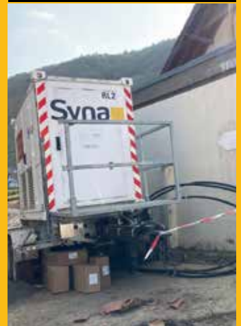
Dauereinsatz eines mobilen Generators (Quelle: Syna GmbH)
