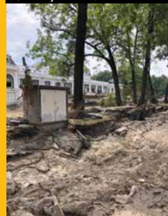
Zerstörte Infrastruktur (Quelle: Syna GmbH)
