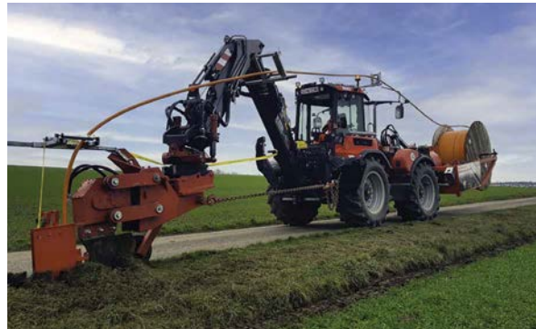
Abbildung 24: Zugmaschine mit Vorrichtung für das Pflugverfahren und Kabeltrommel mit Leerrohr Quelle: econtech GmbH
