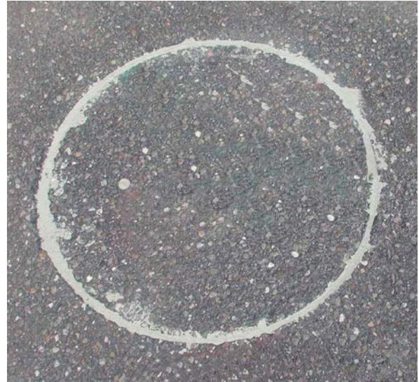
Abbildung 34: Beim Keyhole-Verfahren entsteht ein kreisrunder Schnitt z. B. im Asphalt, der nach abgeschlossener Bohrung abgedichtet wird. Quelle: TRACTO-TECHNIK GmbH & Co. KG
