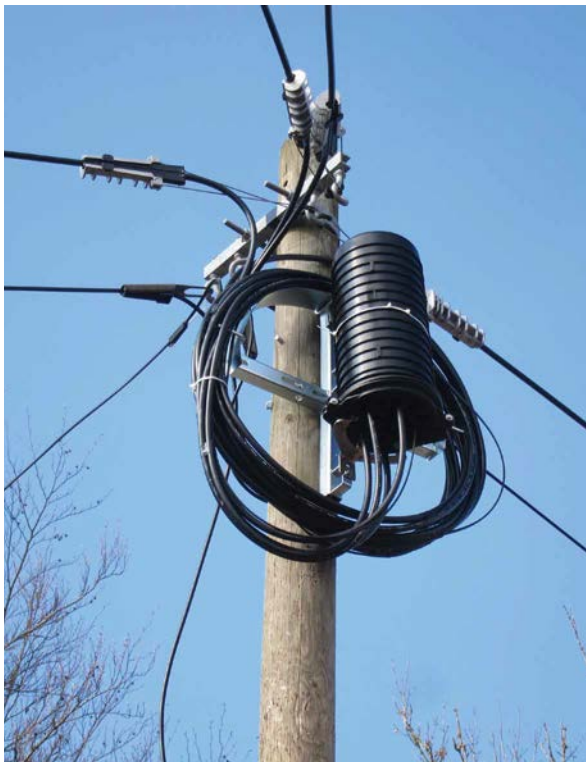
Abbildung 47: Glasfasermuffe am Mast Quelle: Deutsche Telekom Technik GmbH
